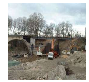
En amont de Ners, réparation du pont de la voie ferrée partiellement emporté (photo BCEOM)
